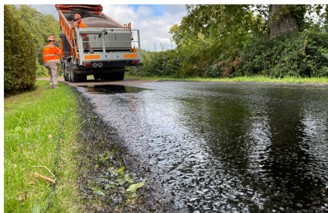
La commune de Vaudebarrier a bénéficié de la pose d'un nouvel enduit sur plusieurs sections de voirie par Le Grand Charolais en 2024.
