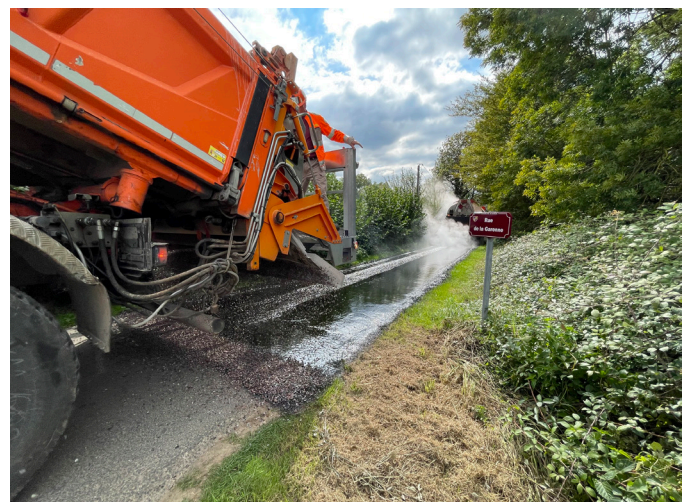
Une route à nouveau étanche avec la pose d'un nouvel enduit, ici à Baron.
