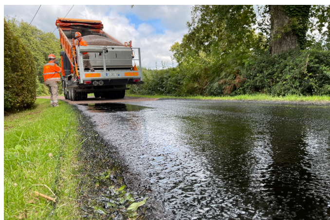
La commune d'Oudry a bénéficié en 2024 de la pose d'un nouvel enduit sur plusieurs sections de voirie, financée par Le Grand Charolais.
