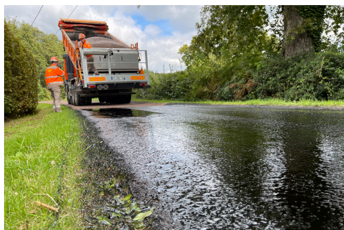
La commune de Hautefond a bénéficié en 2024 de la pose d'un nouvel enduit sur plusieurs sections de voirie, financée par Le Grand Charolais.
