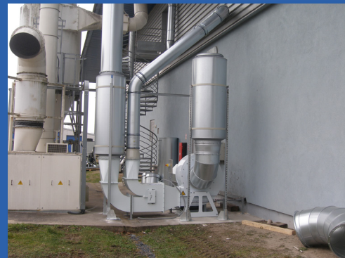
Le système d'aspiration situé à l'extérieur du bâtiment
